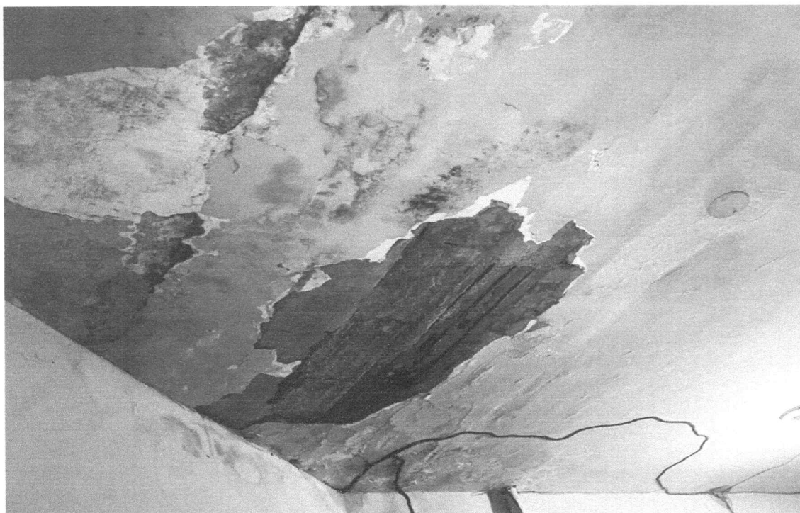
IMAGEM 02: Corrosão nas armaduras. FONTE: SECOB – Secretaria de Obras, Infraestrutura e Recursos Hídricos.
